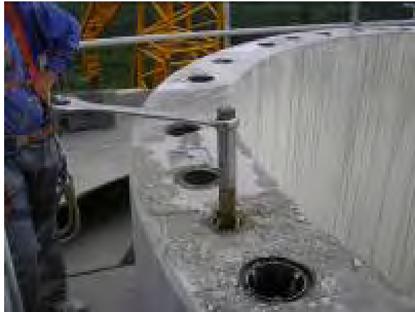
Figure 12: Repassage de filetages endommagés
