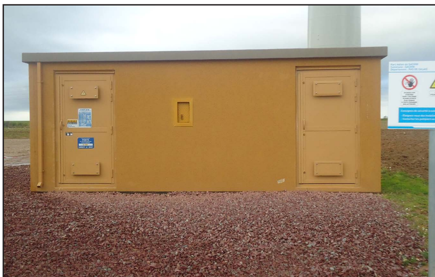
Exemple de poste de livraison fourni par ENERCON
